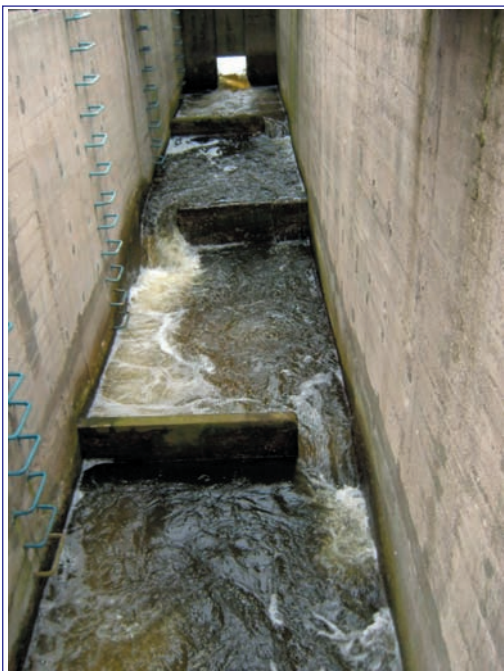
Fot. 1. Przepławka techniczna typu komorowego. Widoczne poprzeczne przegrody oraz otwory przelewowe (fot. J. Kaczmarek).
