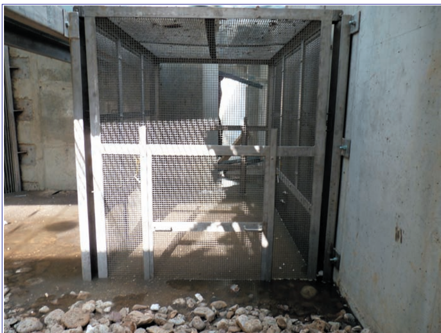
Fot. 8. Pułapka sadzowa wstawiana do komory przeławki i podczas kontroli podnoszona wraz z rybami wysięgnikiem do góry (fot. R. Depowski).
