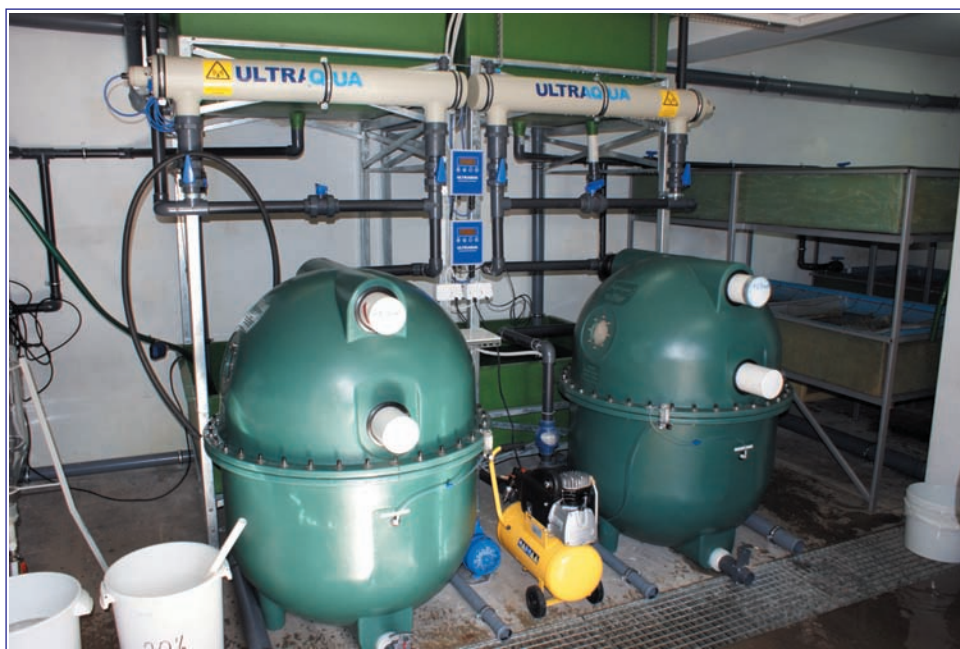
Fot. 1. Wyposażenie wylęgarni w Głodowie współfinansowane ze środków unijnych.
